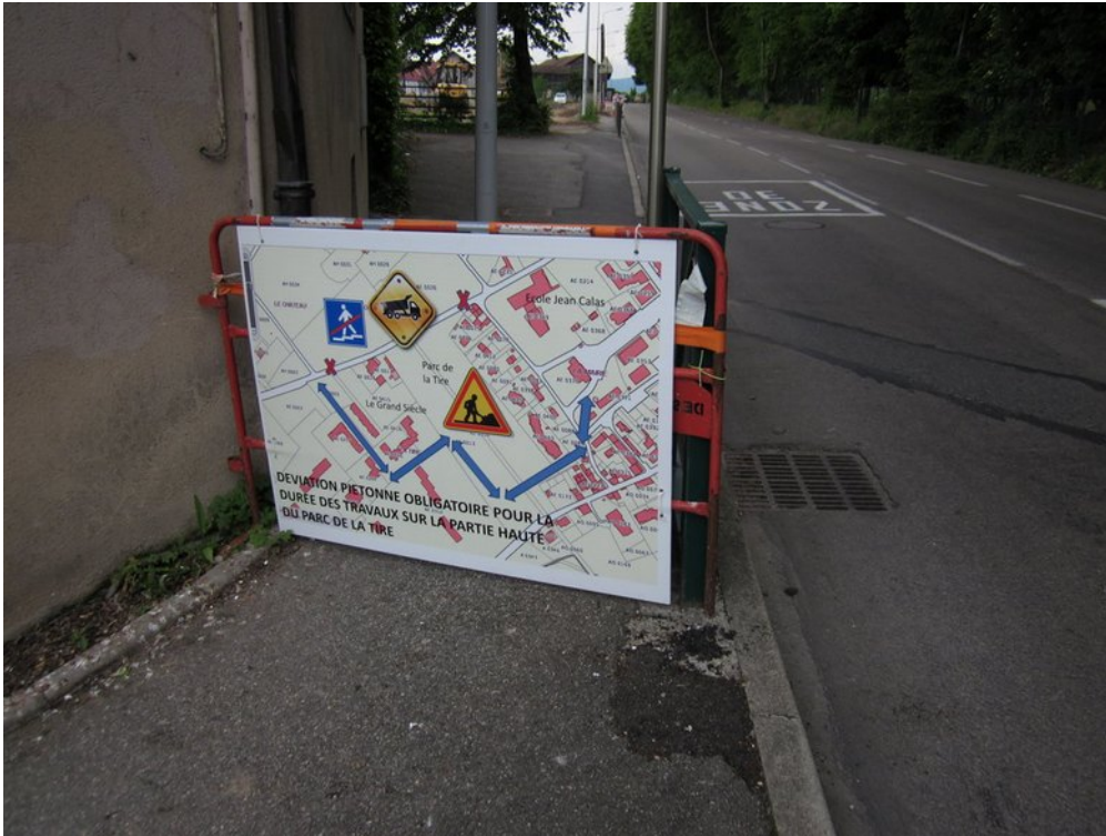
Illustration 7: La circulation piétonne est complètement coupée. La déviation peut largement doubler la distance à franchir, et rallonge le chemin de plusieurs centaines de mètres.
